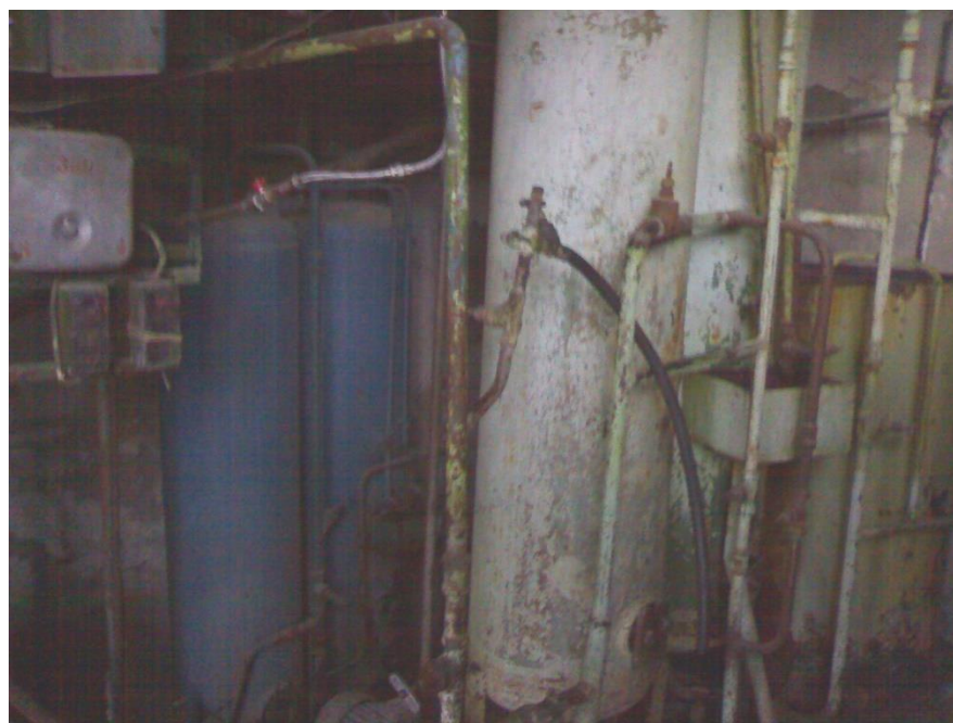
Рисунок 2.5 – Установка ХВО котельні
