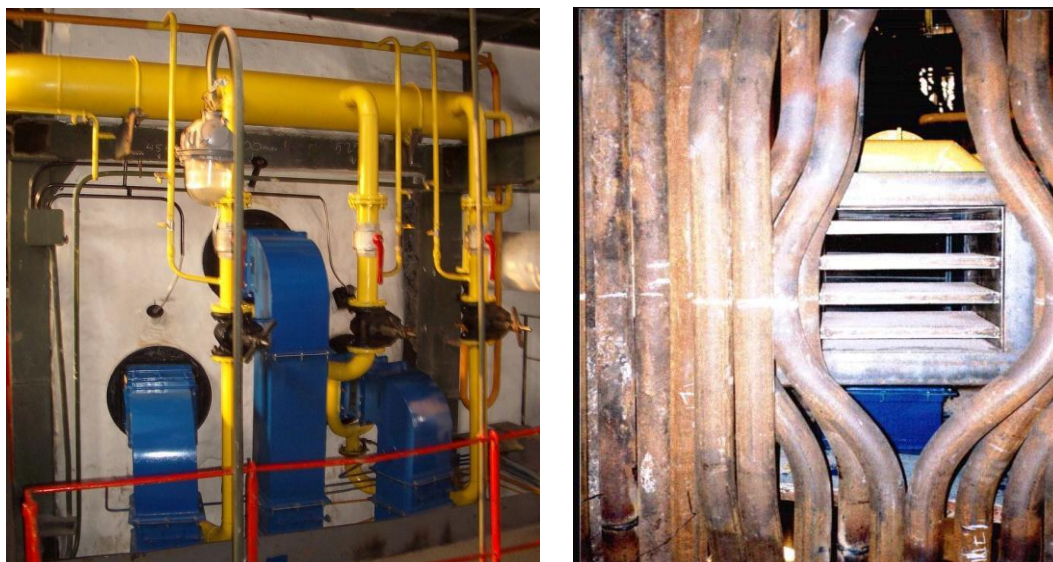
Рис. 1.9 ПП СНТ на котлі ПТВМ-30
