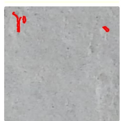
Знайдені дефекти (червоні контури)
