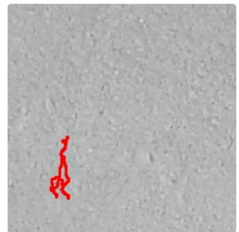
Знайдені дефекти (червоні контури)
