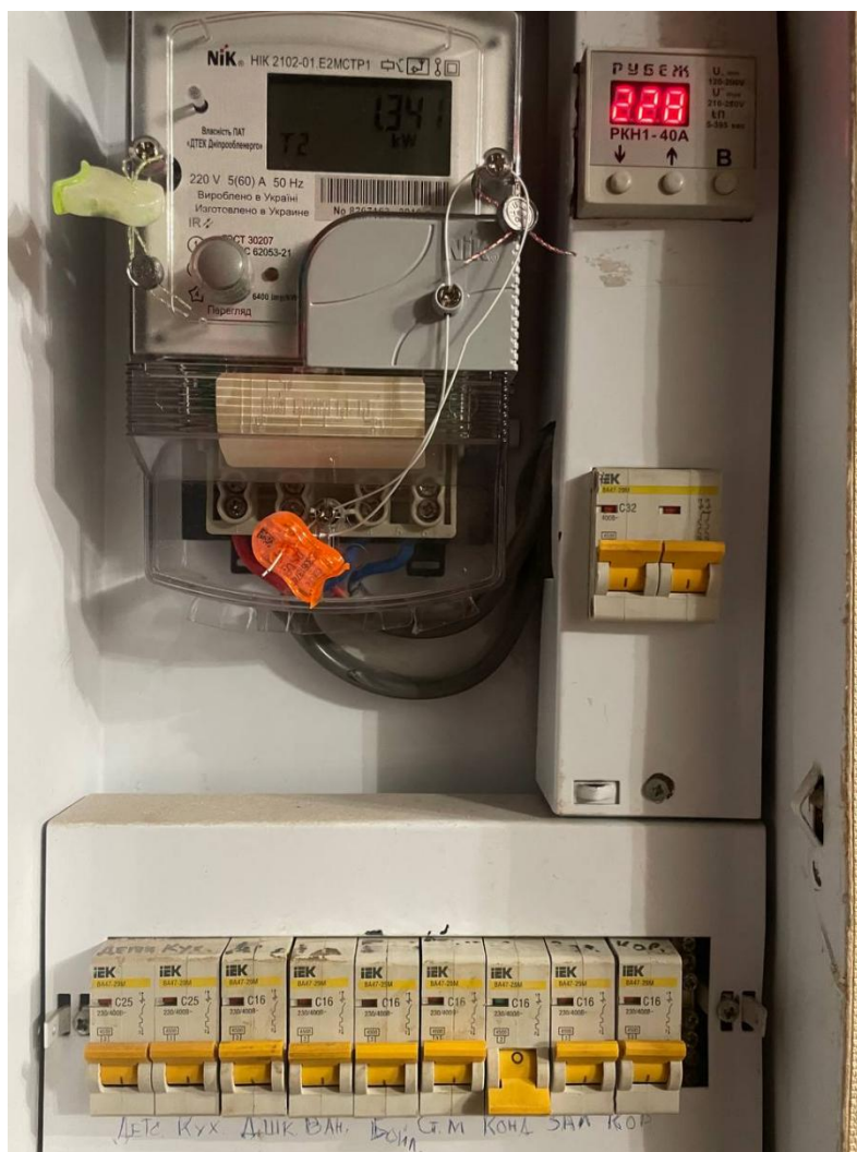
Рисунок 2.5 — Приклад розподільного щиту в квартирі
