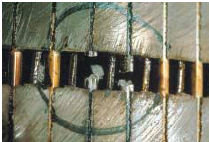
Рисунок 2.3 – Пошкодження литих короткозамкнених обмоток ротора АД
