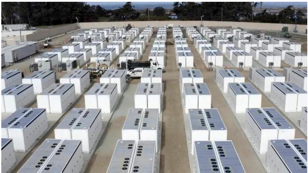
Рисунок 3.5 – Акумуляторна станція «Tesla Megapack battery» в Каліфорнії
