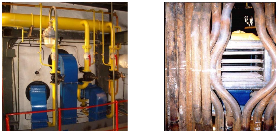
Рис. 1.16 ПП СНТ на котлі ПТВМ-30
