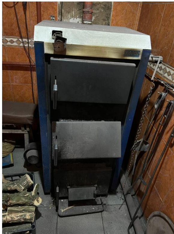
Рисунок 1.7 – Твердопаливний котел системи опалення житлового будинку
