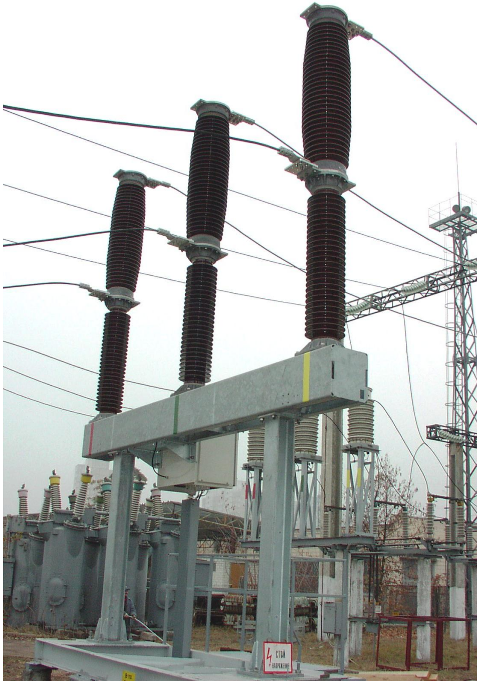
Рисунок 2 – Загальний вигляд елементного вимикача напругою 110 кВ, встановленого на підстанції 110/35/10 кВ «Лівобережна» ПАТ «Київенерго»
