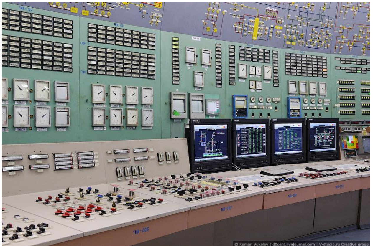
Рисунок 6.1 - Пульт керування атомною електростанцією.
