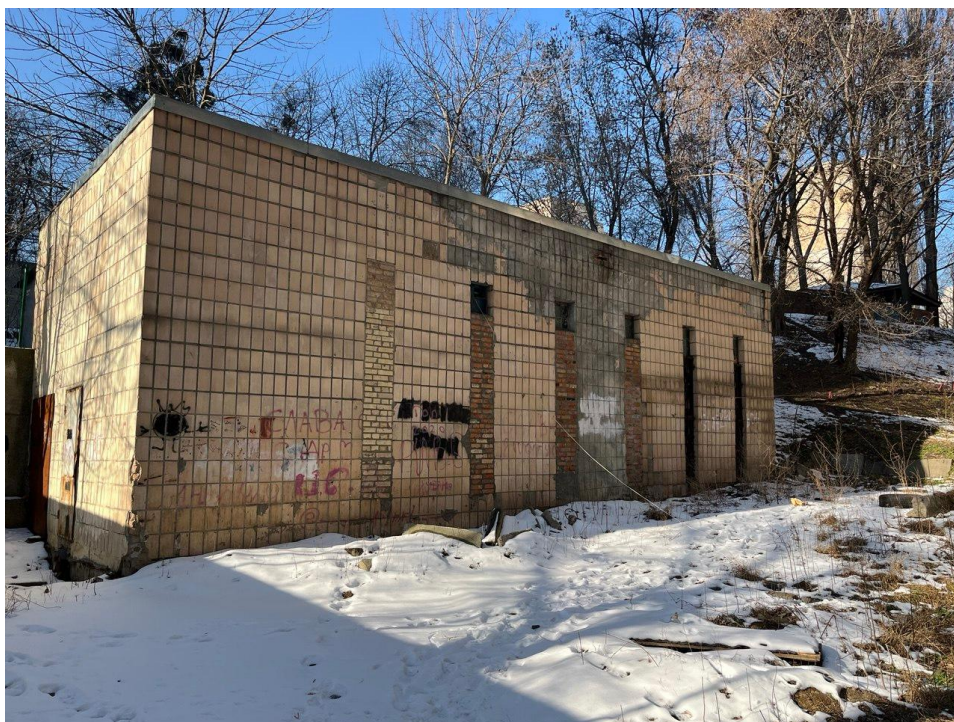
Рисунок 2.1 – Трансформаторна підстанція, розташована за адресою вул. Ковальський провулок, 22А
