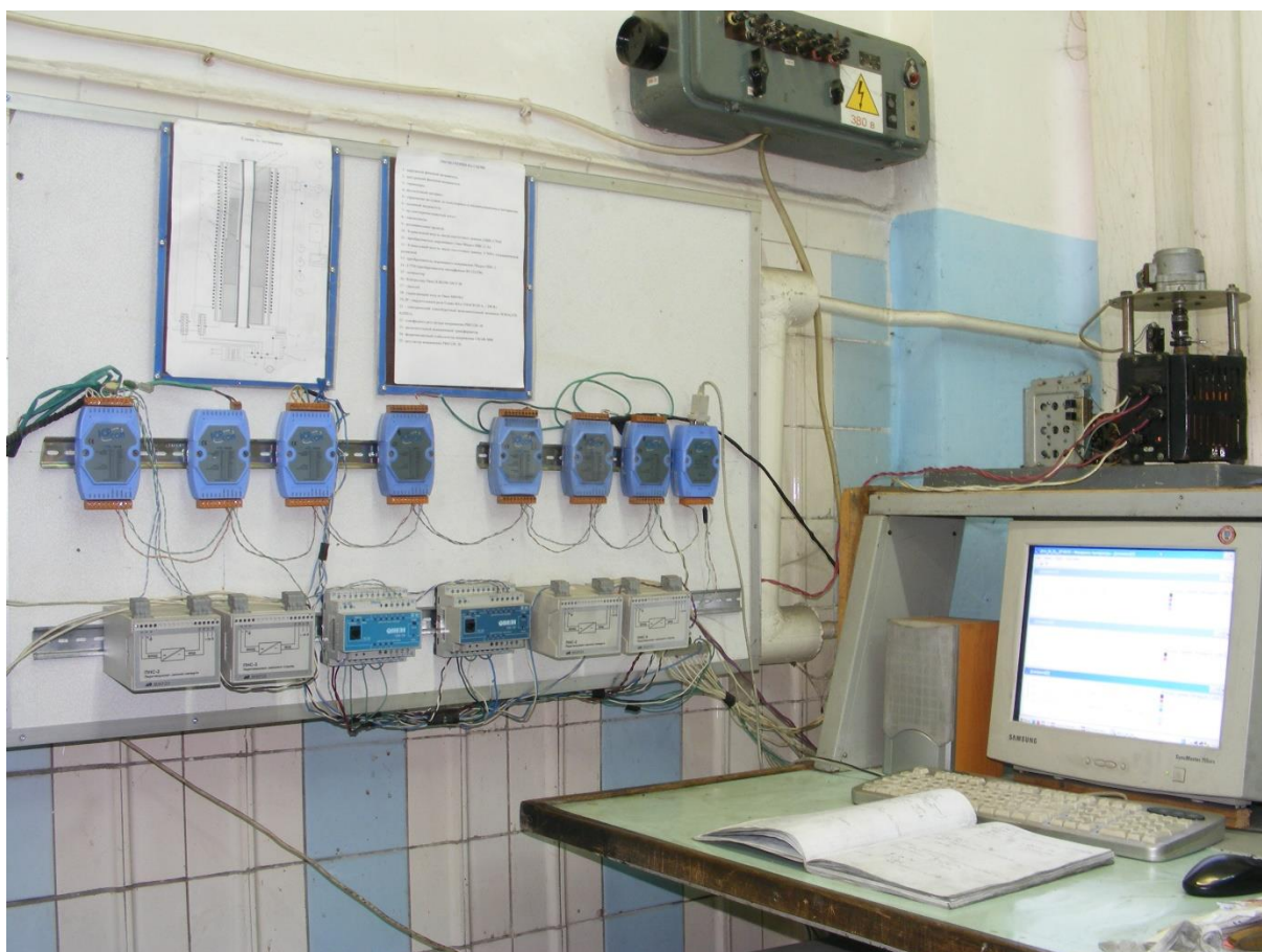
Рис. 2.14. Фотознімок стенду із системою автоматики експериментальної установки
