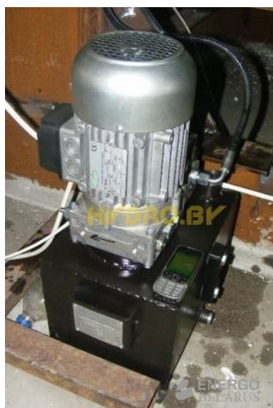
Рисунок 6.2 – Міні гідростанція НС-014 – Hydronit
