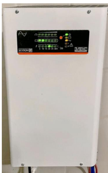
Рис.3.4. ДБЖ в роботі від мережі. Процес заряду акумулятора 200Ah(GEL).Об'єкт 2
