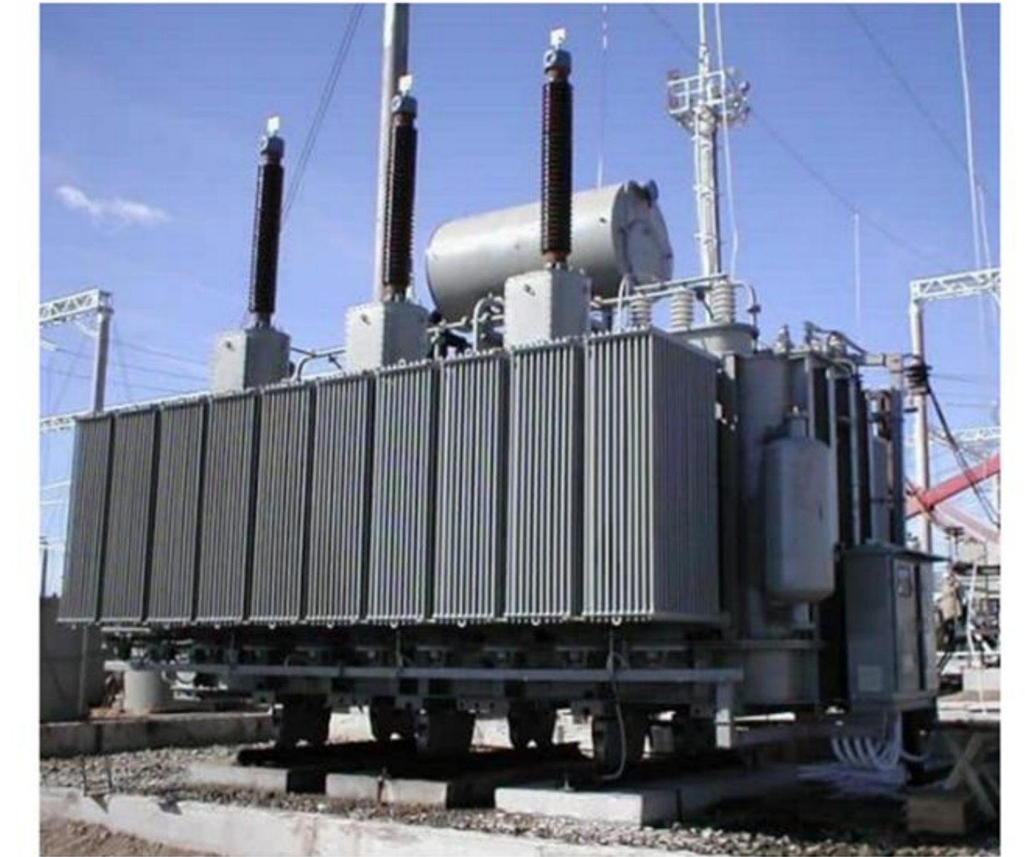
Керований шунтуючий реактор
