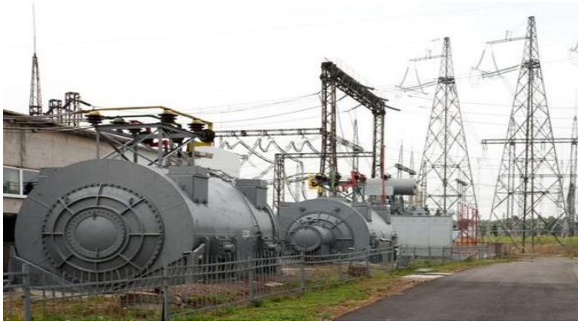
Синхронний компенсатор на підстанції 750 кВ
