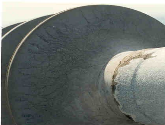
Рис. 1.44. Мікротріщини по поверхні ізолятора
