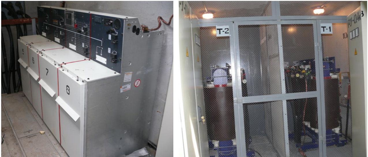
Рисунок 2.15 – Зовнішній вигляд встановлених шаф 0,4 кВ та силових трансформаторів
