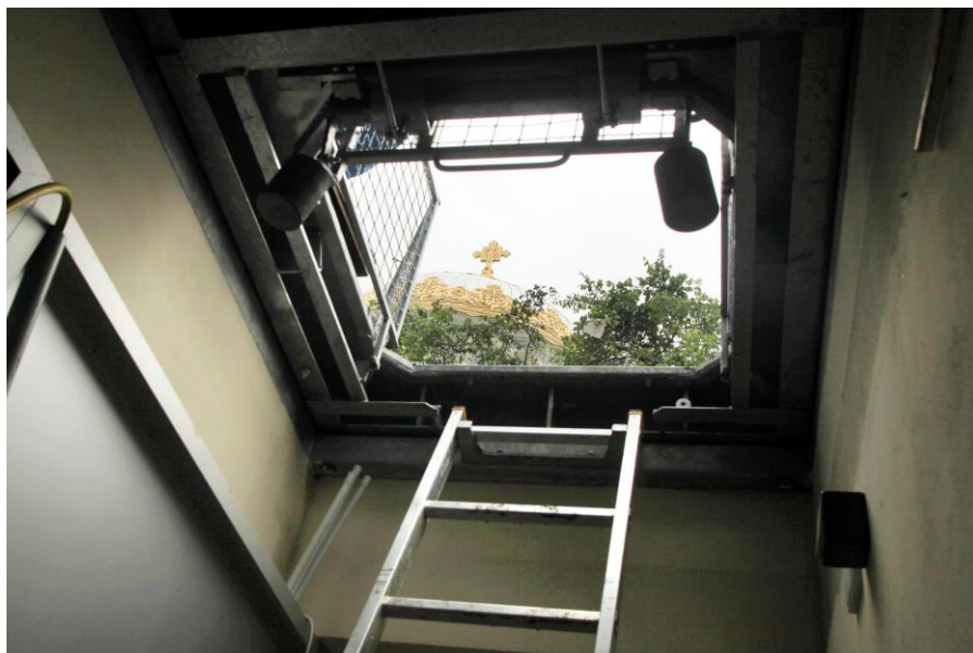
Рисунок 2.18 – Люк для доступу в приміщення ТП
