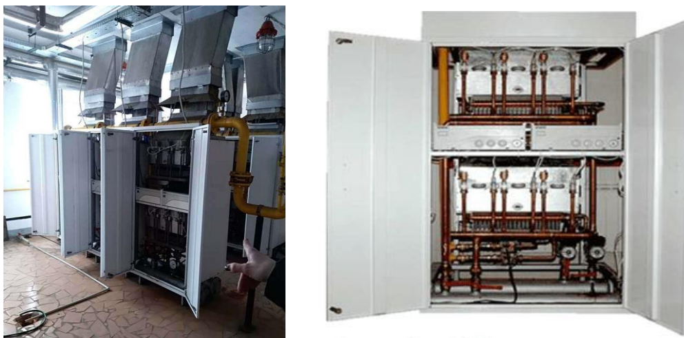
Рисунок 2.7 – Існуючі котли Колві-192 в даховій котельні
