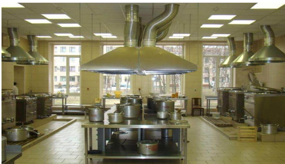
Рисунок 3.1 – Приміщення гарячого цеху і обладнання в ньому
