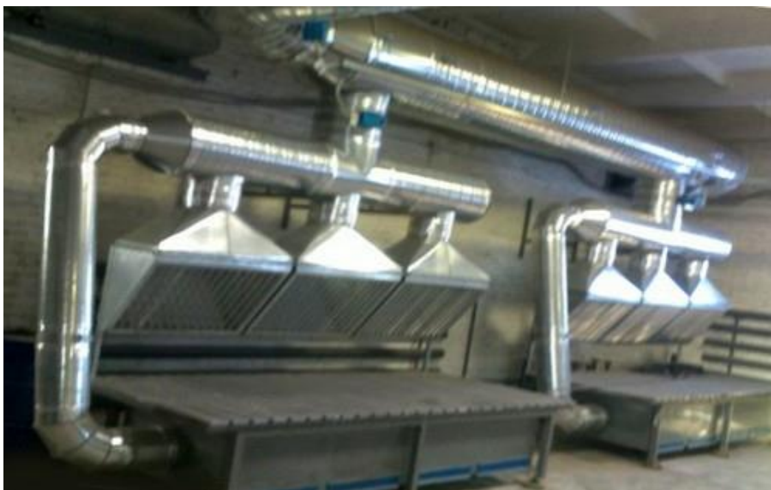
Рисунок 1.2 – Зовнішній вигляд локального витяжного зонту у зварювальному цеху
