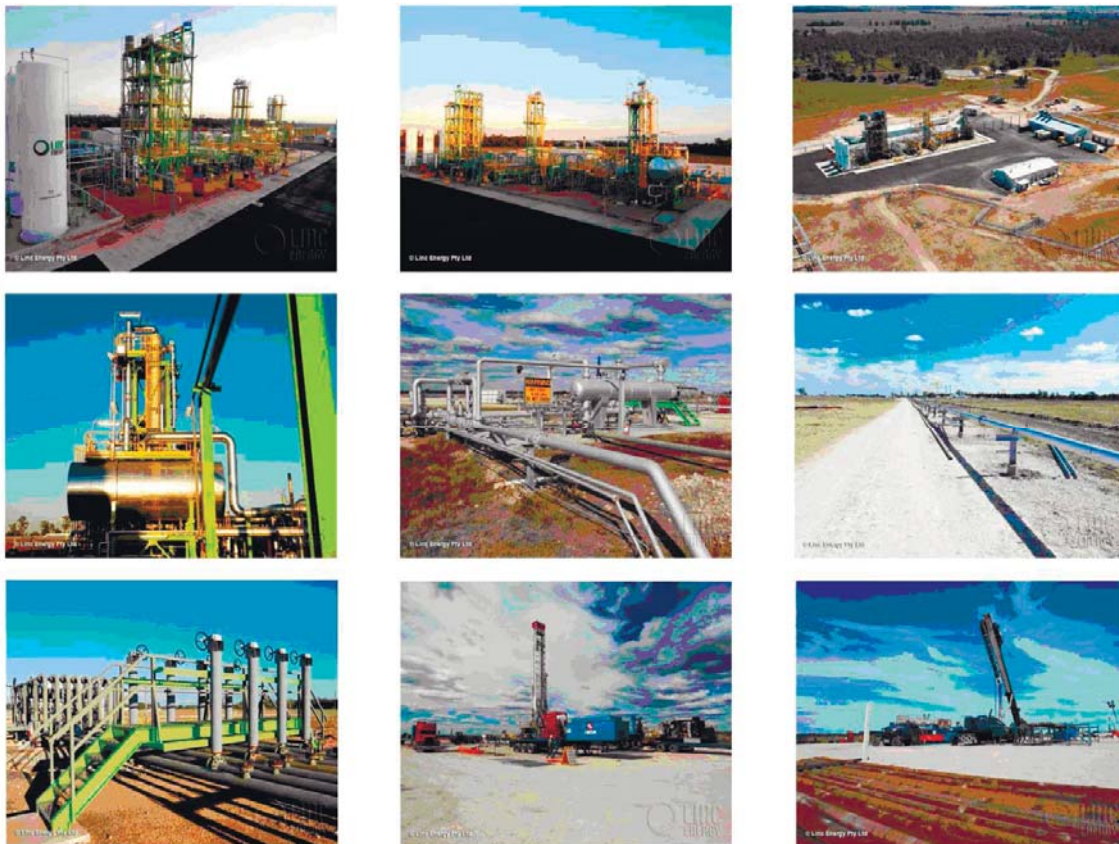
Рис. 7.35 – Загальний вигляд об'єктів сучасної станції ПГВ (Австралія, Квінсленд, проект CHINCHILLA UGG)
