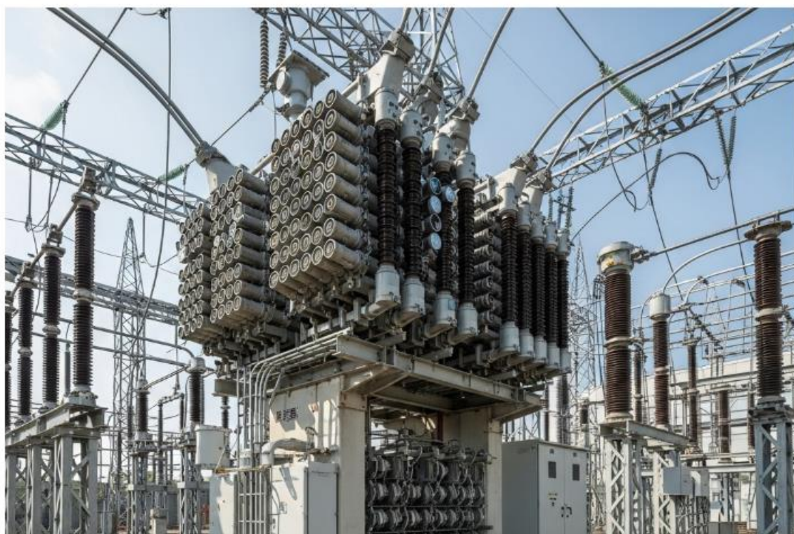
Рисунок 1.3 - Встановлення статичного компенсатора реактивної потужності (SVC) на підстанції
