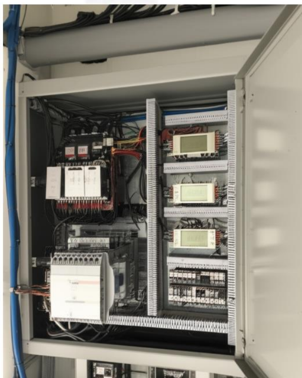
Рисунок 1.6 - Внутрішнє обладнання шафи автоматичного регулятора напруги трансформатора
