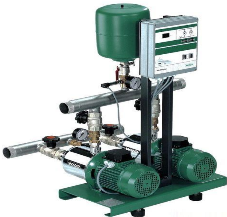
Рисунок 3.10 – Насосна станція підживлення котлового контуру
