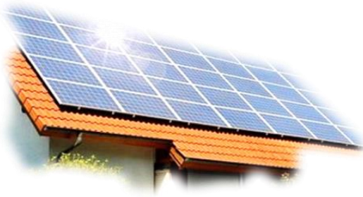
Рис. 3.16. Дахова сонячна електростанція
