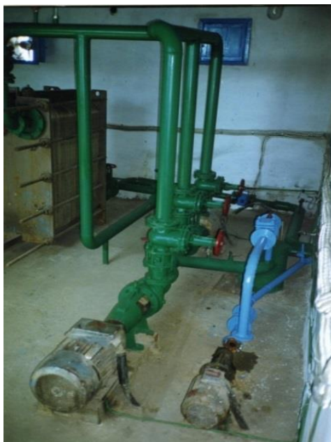
Рис. 6.6. Мережевий насос та насос для підживлення
